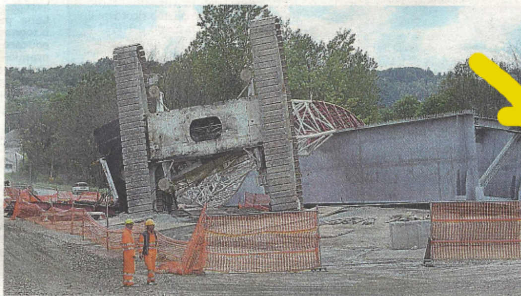
CROLLO La gru e la campata precipitate al suolo: verranno rimosse nei prossimi giorni
